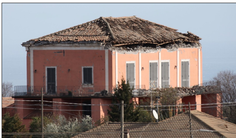
Figura 11 – Fiandaca: gravi danni ad un edificio in muratura (classe B).
