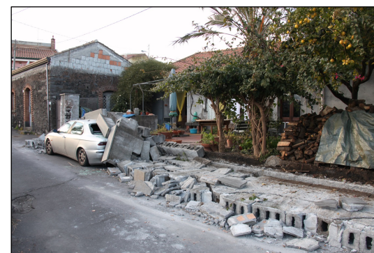
Figura 20 – Scacchieri: il crollo di un muro perimetrale sulla strada danneggia un'auto posteggiata.
