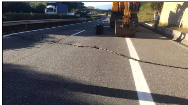
Figura 17 – Autostrada A18: fagliazione cosismica sulla carreggiata per Catania; il transito è rimasto interrotto per un giorno e poi ripristinato su un'unica corsia per oltre una settimana (Foto: Gazzettinonline del 28/12/2018).
