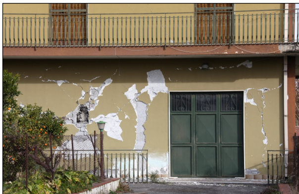
Figura 12 – Fossazze: lesioni profonde e rottura parziale delle tramezzature in un edificio in c.a. (classe C).
