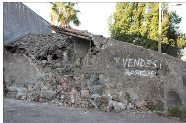
Figura 13 – Scacchieri: crollo parziale di un edificio rurale in pietra grezza (classe A).
