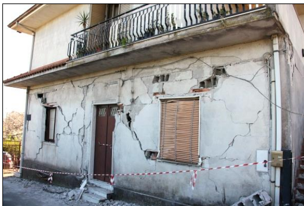
Figura 6 – Mazzasette: danno grave (lesioni a croce di S. Andrea, grado 3) ad un edificio in muratura (classe B).
