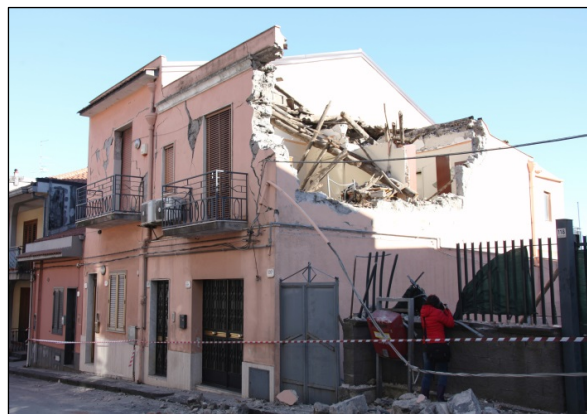
Figura 7 – Fleri: crollo parziale (grado 4) di un edificio in muratura (classe B).
