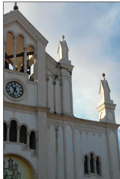
Figura 15 – Cosentini, chiesa di Maria SS. del Rosario: rottura di un capitello della facciata.
