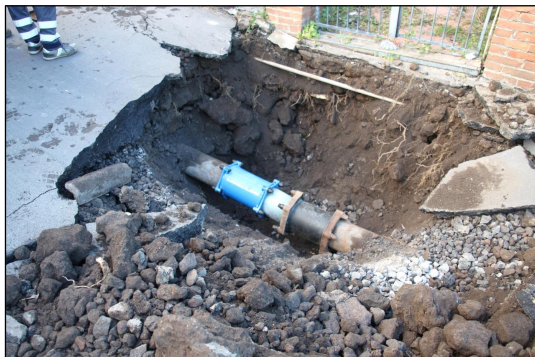
Figura 16 – S. Maria la Stella, via Cordovado: riparazione dell'acquedotto comunale, rotto dal movimento cosismico della Faglia di Fiandaca.
