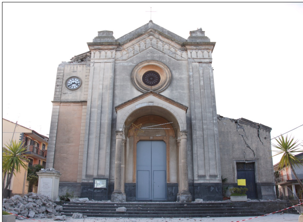
Figura 10 – Pennisi, chiesa della Madonna del Carmelo: particolare del crollo del campanile e del salone parrocchiale.
