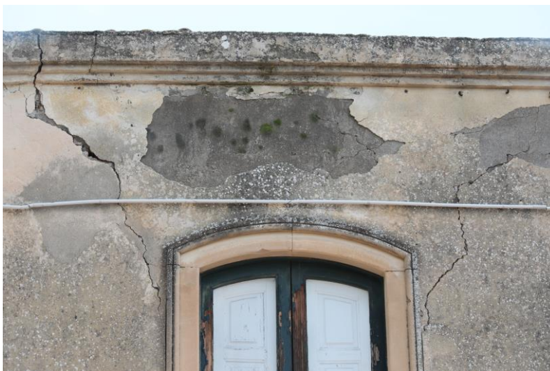
Foto 1. Ragalna: crepe alla muratura esterna di un edificio in muratura di classe di vulnerabilità B.
