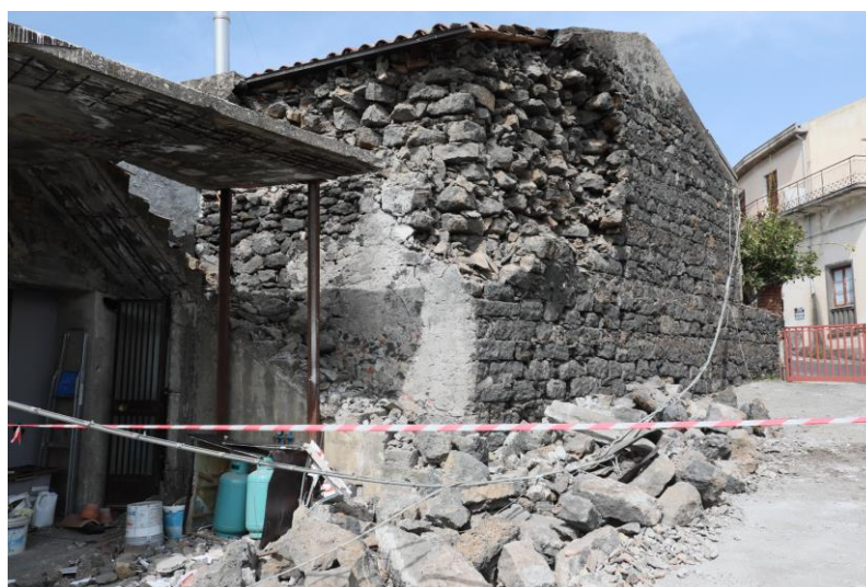
Foto 2. Ragalna: crollo parziale di un edificio in muratura grezza di classe di vulnerabilità A.
