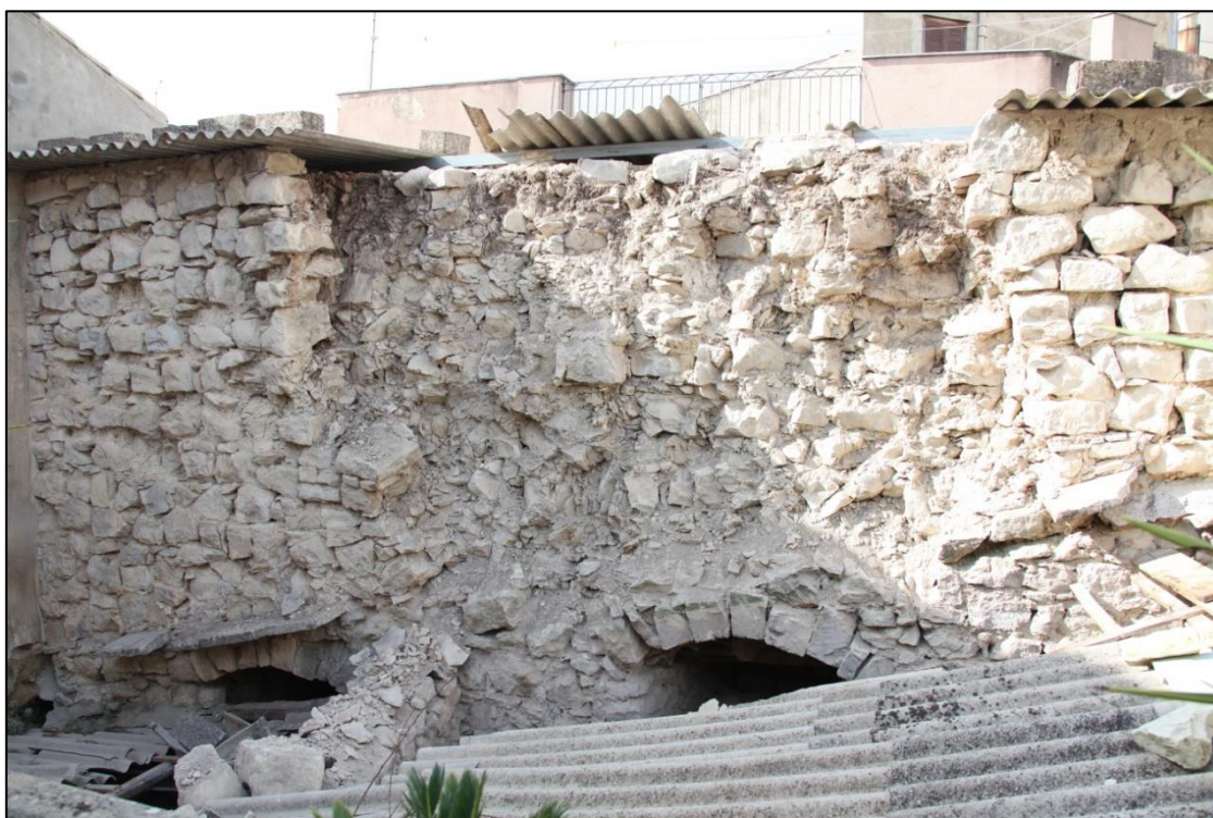
Fig. 2 - Giarratana. Crollo di parte di un muro perimetrale "a sacco", in edificio abbandonato.
