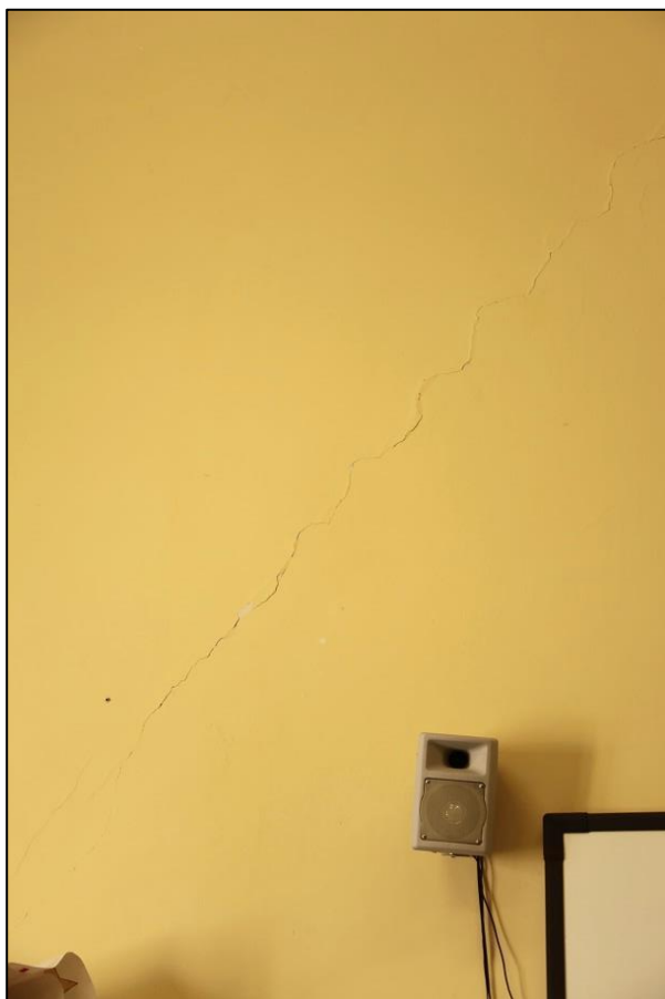
Fig. 3 - Giarratana. Lesioni agli intonaci della scuola elementare L. Capuana (plesso di Piazza Martiri d'Ungheria): gli effetti riguardano le tramezzature del 2° piano f.t., per la non continuità con le murature del piano terra.
