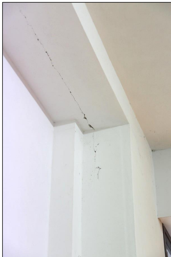
Fig. 4 - San Giacomo (frazione di Ragusa). Lesione e distacco tra le travi di un edificio in c.a. adibito a capannone commerciale.
